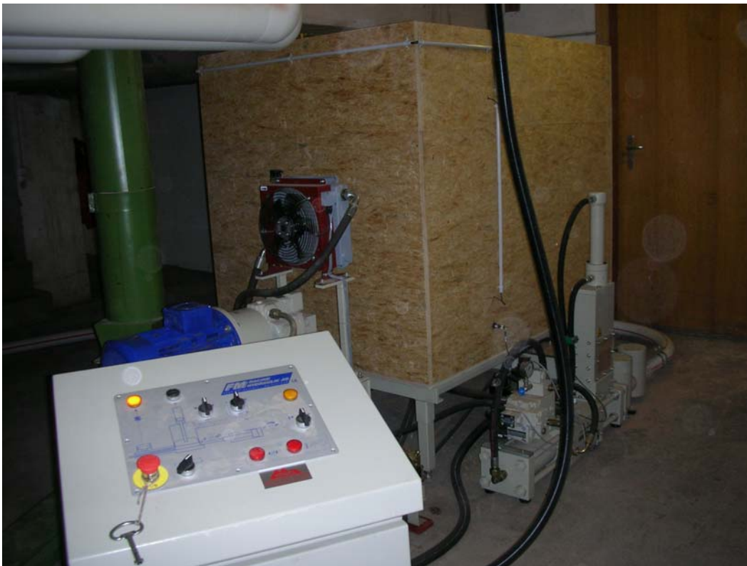
Ansicht Brikettieranlage mit Schaltkasten Ölkühler und Schubboden
